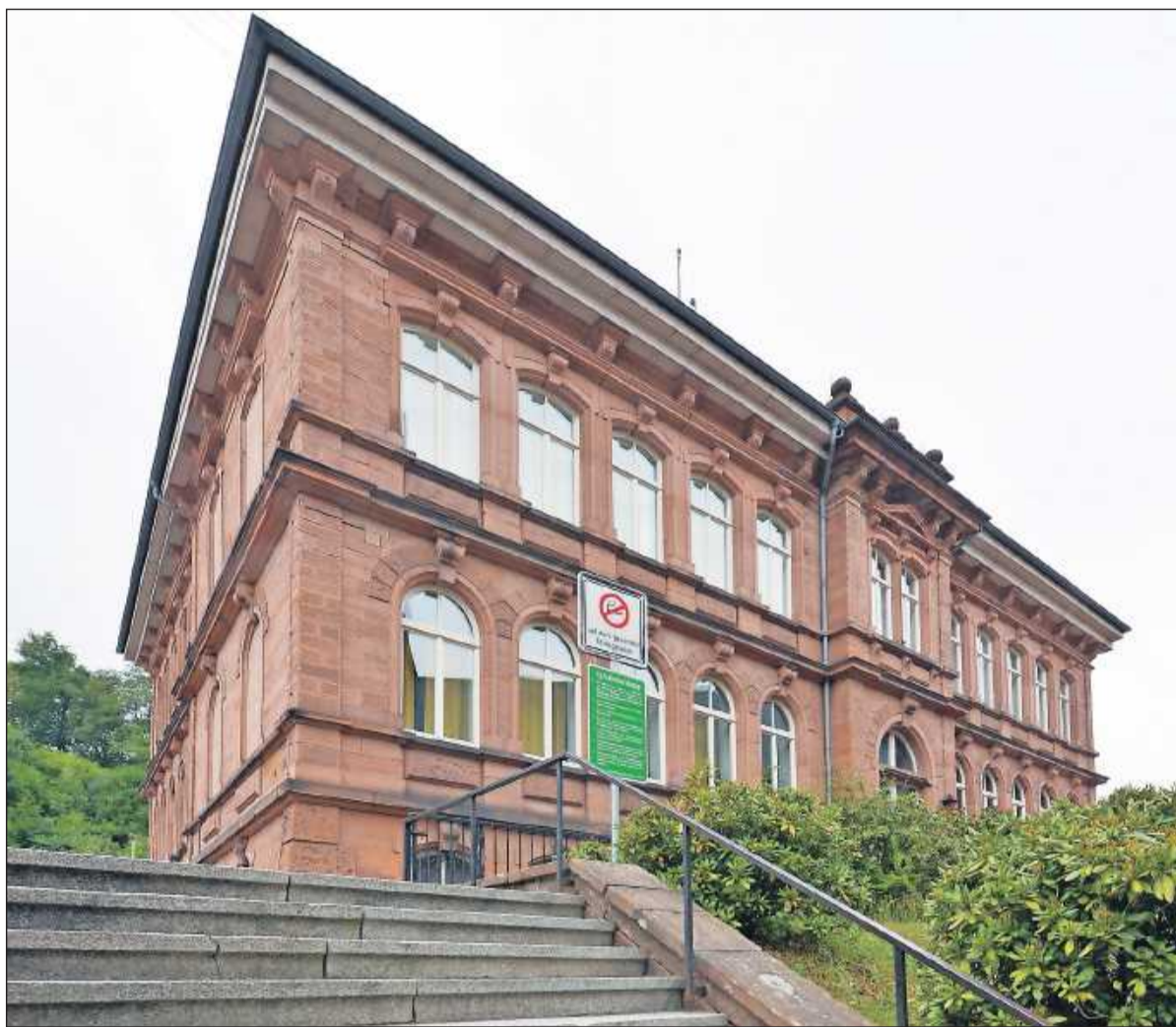
Die Grundschule Weidenthal ist in einem repräsentativen alten Sandsteinbau untergebracht. Der muss aber aus Sicht des Brandschutzes nachgerüstet werden.
